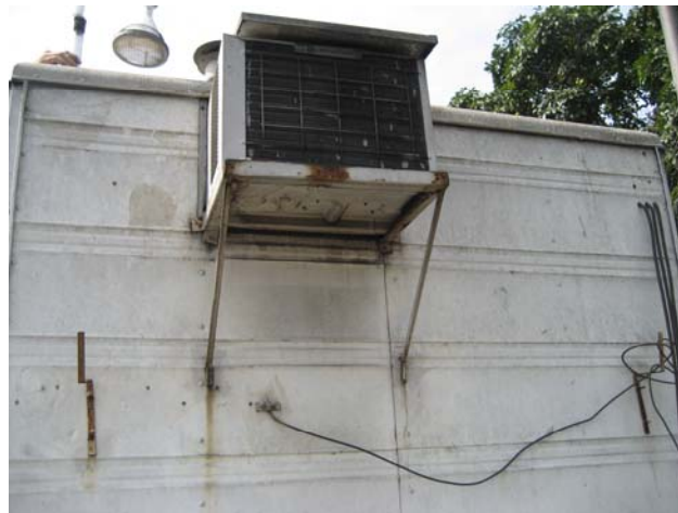
Figura #4. Imagen del sistema de enfriamiento, en esta imagen se puede observar el tipo de construcción que se utilizó, el cual no es aislante.
